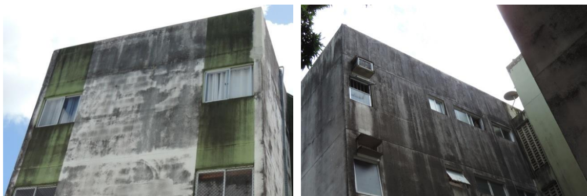
Foto 3 – Exemplos de manchas decorrentes de biodeterioração
