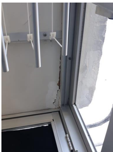
Foto 5 – Exemplo de falha de vedação
