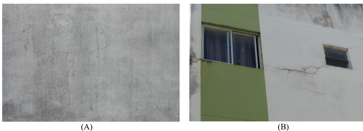
Foto 4 – Exemplo de fissuras (A) e trincas (B)
