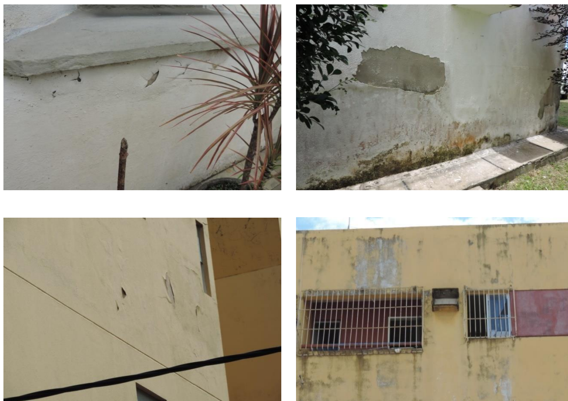
Foto 8 – Exemplos de degradação da pintura
