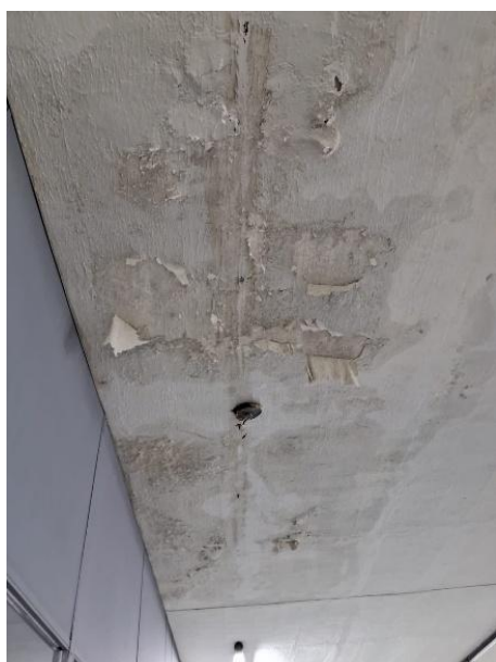
Figura 4: Infiltração na laje da Clínica A. Fonte: Acervo da autora(2025).
