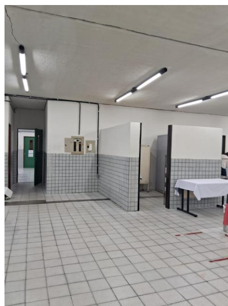
Figura 5: Ausência de revestimento no piso da Clínica B. Fonte: Acervo da autora(2025).
