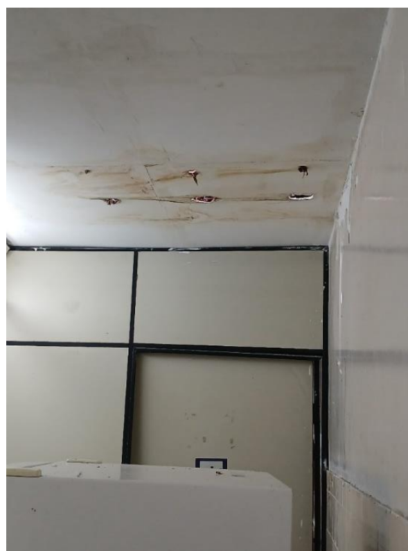
Figura 35 – Departamento de Ciências Farmacêuticas: forro desgastado. . Fonte: Acervo do autor (2024)
